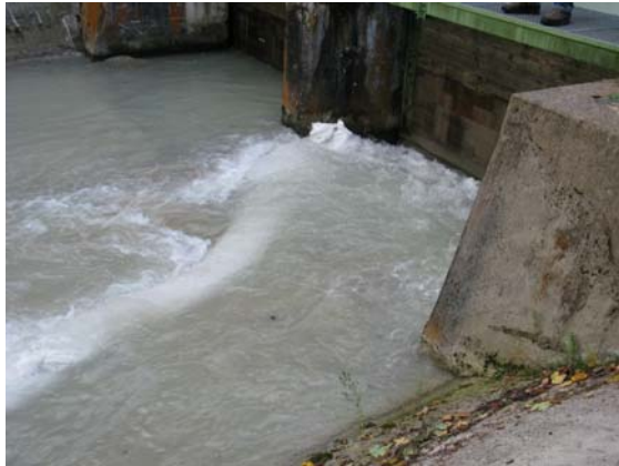
Abb. 5: Überströmte 1er Barriere unterhalb des Schützes.
