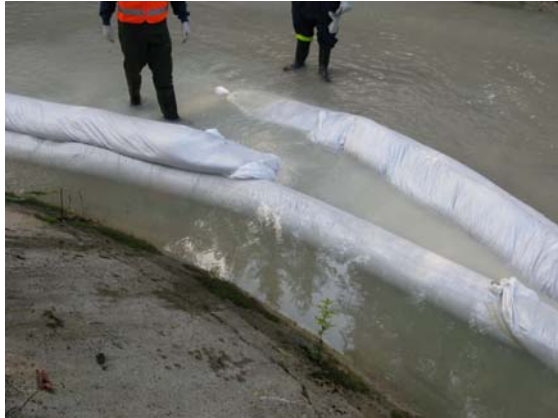
Abb. 9: Beschädigte 3er Barriere in der Kurve nach Abflussreduzierung.
