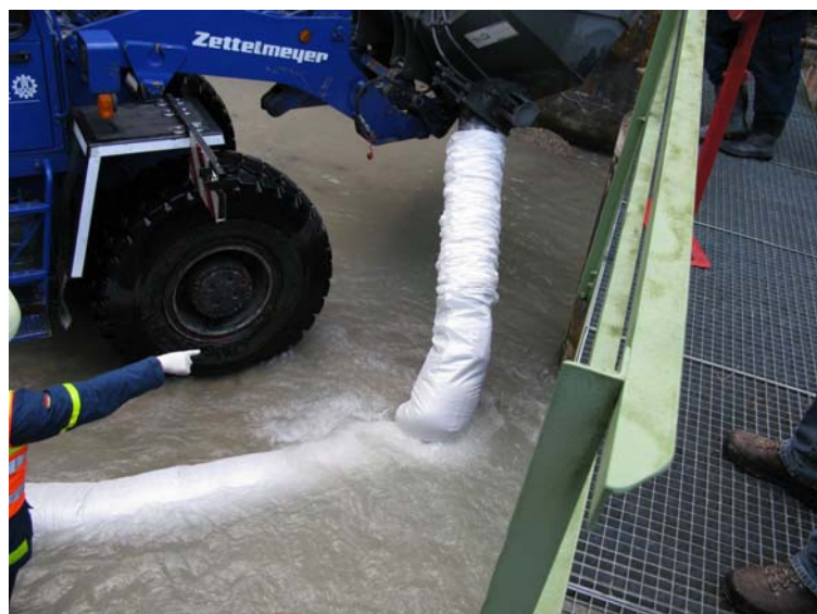
Abb. 4: Verlegen des ersten Sandschlauchs kurz vor dem Anschluss an den Mittelpfeiler bei vorhandenem Abfluss.
