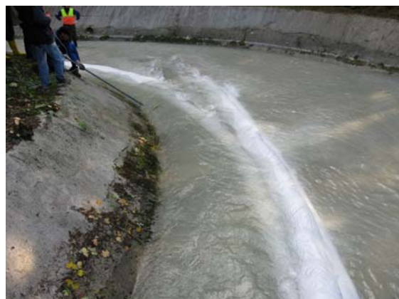
Abb. 8: Überströmte 3er Barriere in der Kurve nach Eintreten des Schadens.
