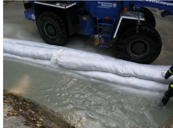
Abb. 14: Überlappung des obersten Schlauchs der 7er Barriere.
