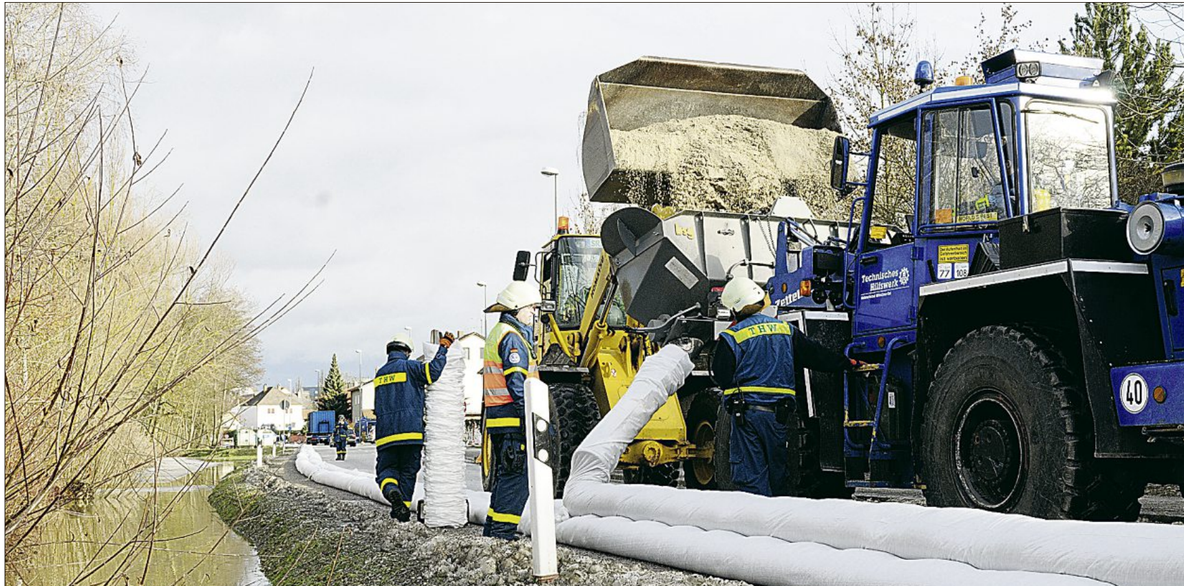
Der gelbe Radlader befüllt die Schaufel des blauen vom THW mit Sand, damit dieser zügig die 25-Meter-Schläuche mit Sand füllen und gleichzeitig verlegen kann.
